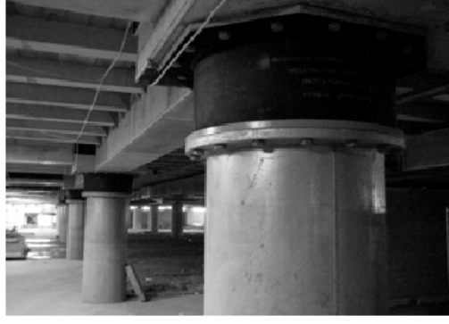
Şekil 2.14 : “Wellington Regional Hospital” binasında kullanılan izolatörler.
