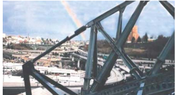
Şekil 7 - Çelik Kafes Sisteme Viskoz Akışkanlı Sönümleyici Uygulaması
