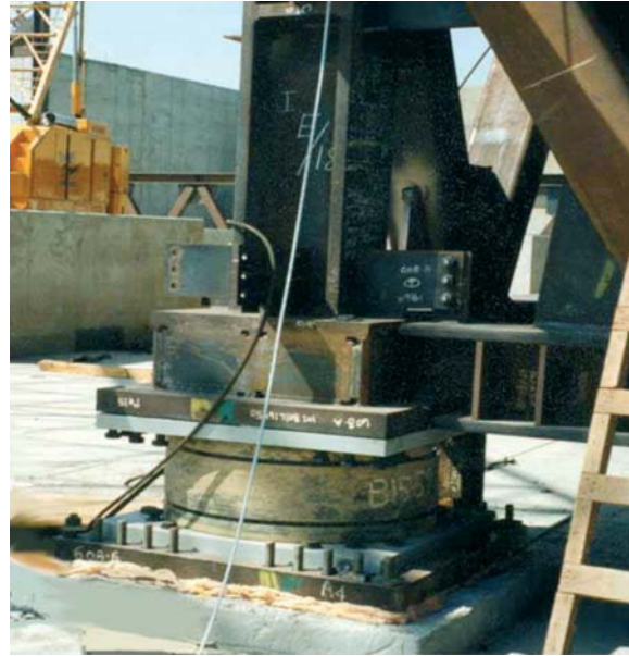
Şekil 10 - Çelik Kolon Altına Yerleştirilmiş İzolatörler
